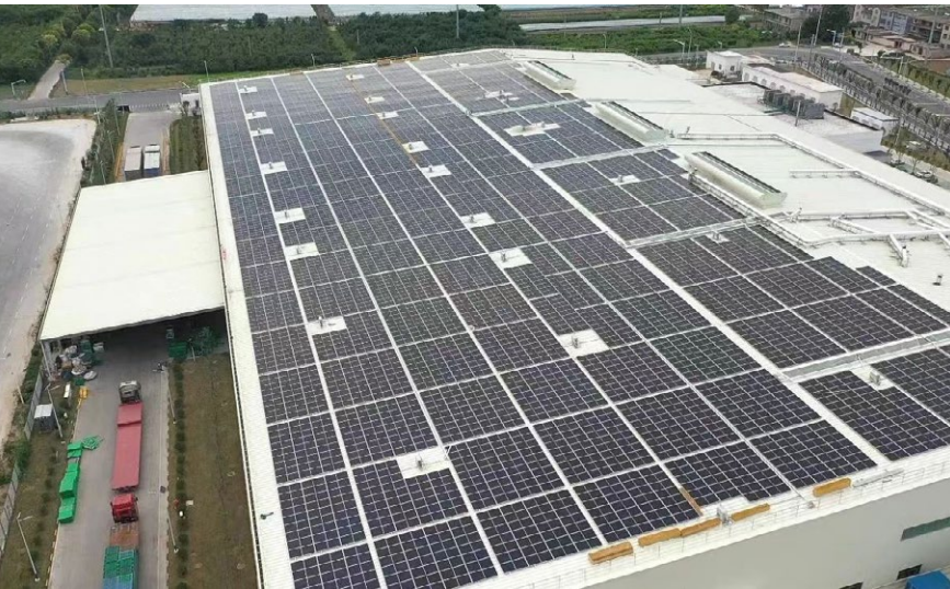
◎ 蚌埠工厂光伏项目
