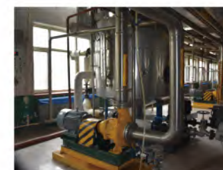
糖化冷凝水回收设备
